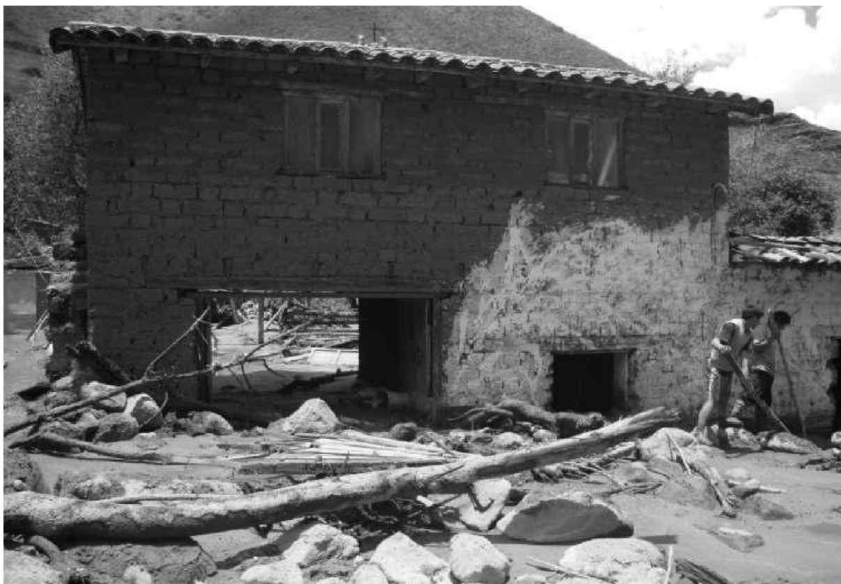
Daños causados en la vivienda de Nicolasa Quispe sector de Yanacona. Fuente Municipalidad de Urubamba.
